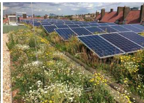
Panneau photovoltaïque en toiture sur bâtiment industriel, Clapham Park, Londres
